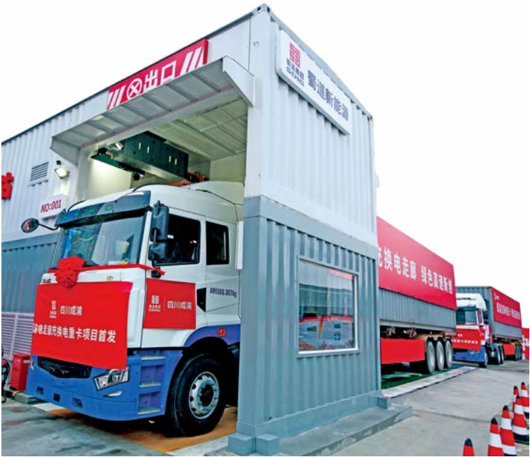
成渝高速公路重卡充换电站
