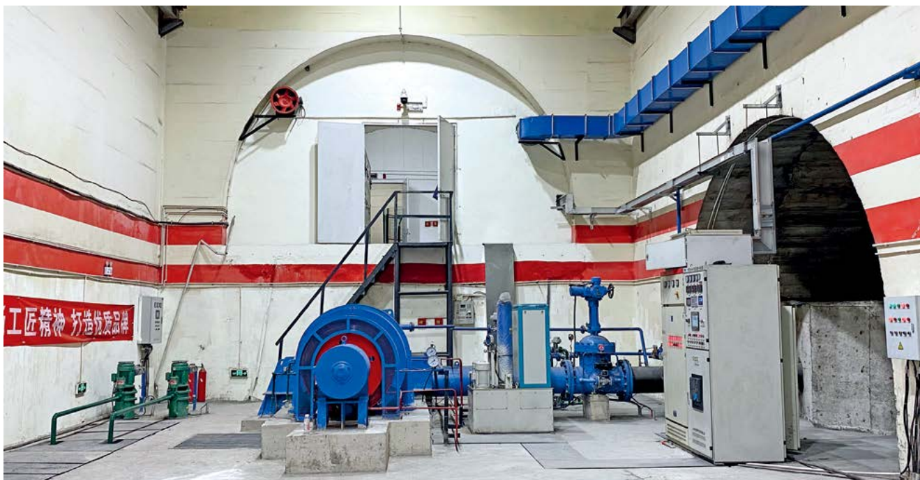
雅康高速二郎山隧道发电机房
